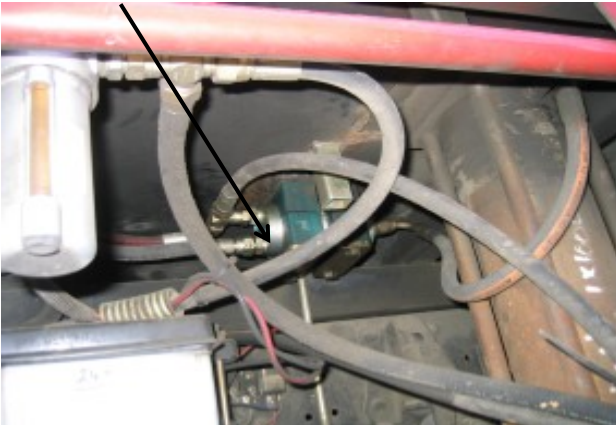
Der Druckverstärker HC4 unter dem LKW-Aufbau
